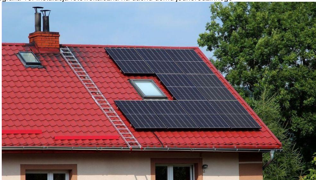
Fotografia 10. Instalacja fotowoltaiczna na dachu domu jednorodzinnego
